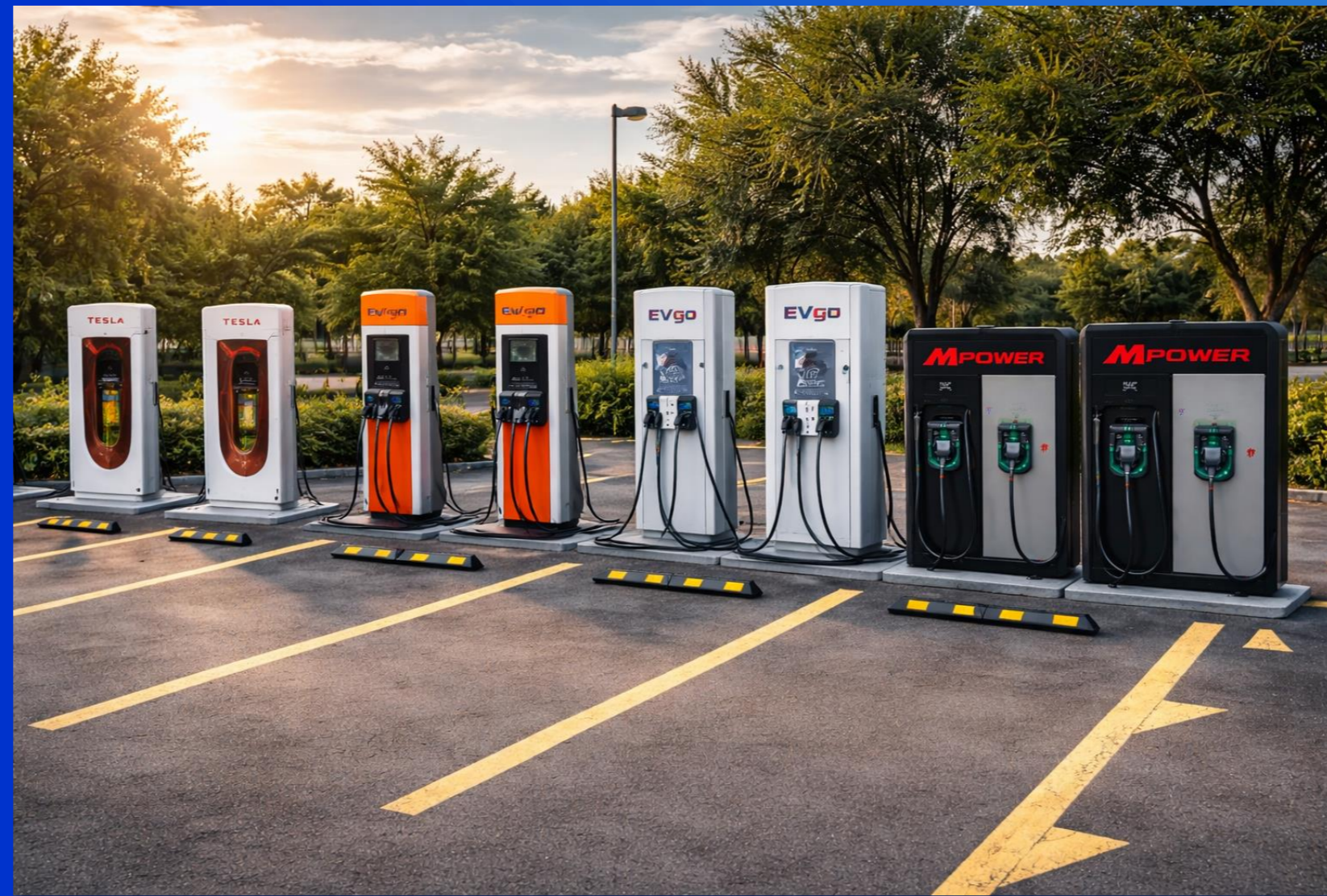
Trạm EV hiện hữu
